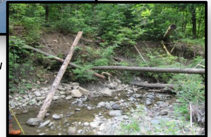
Érosion des berges du ruisseau
