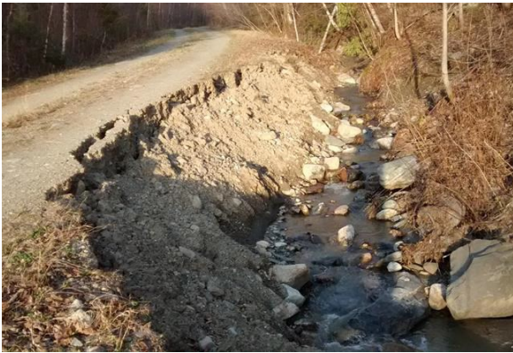
Chemin forestier mal aménagé dans une pente de 7 %. Détérioration du chemin due à l'érosion et coûts de réparation importants à prévoir.
