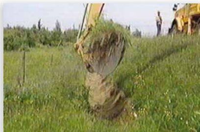
Excavation du fond du fossé à partir du talus opposé à la route, jusqu'à l'entaille.
